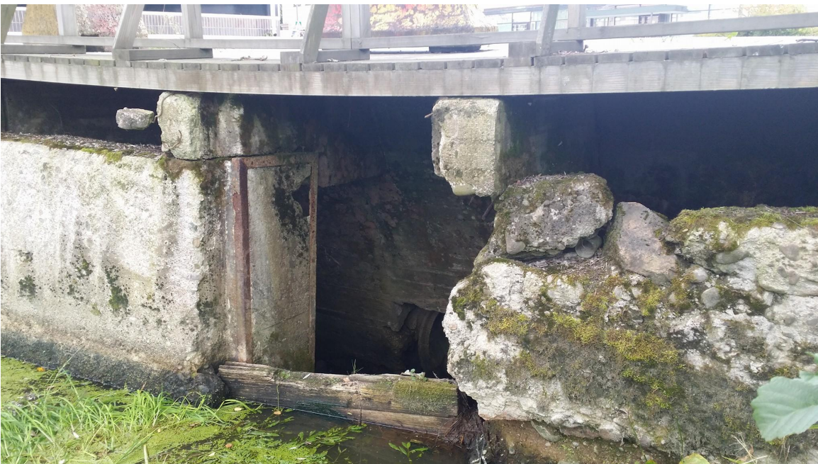
Kuva 8: Pato. Kuvassa näkyy vanhan padon laudoitusta vesirajassa. Rikkoontunut betoni ja tyhjän päällä oleva palkki, joka kannattelee päälle väliaikaisesti rakennettua laituria.
